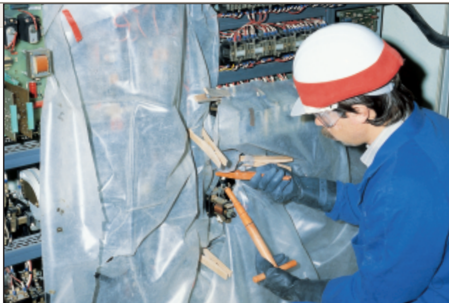
Toute intervention sur une armoire électrique doit être effectuée en respectant des consignes de sécurité très strictes et avec un matériel adapté (photo Cousson - Formation à la sécurité à EDF)
